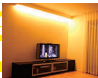
全館LED照明
